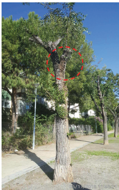
Detalle: Chancro en rama primaria y aparición de grietas verticales
