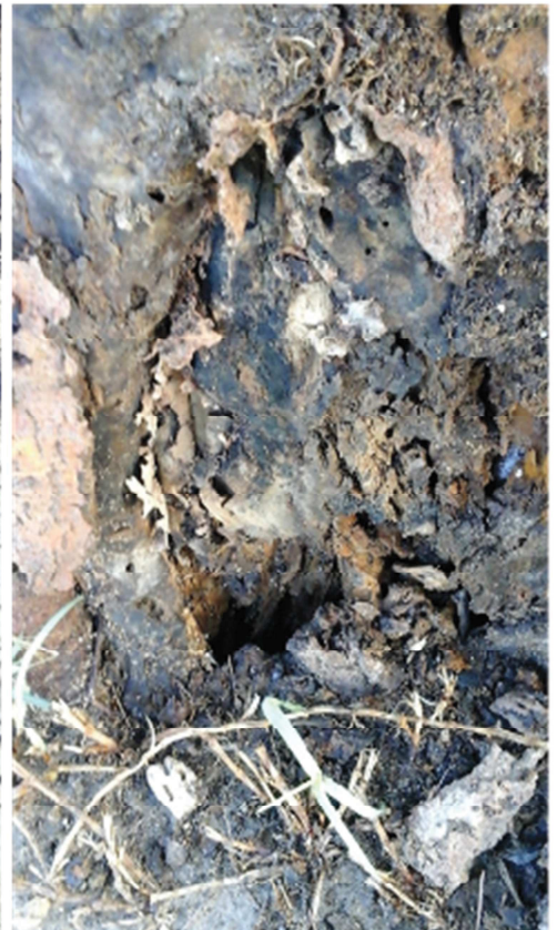
Cavidad en la base del tronco/cuello del árbol que seguramente afecte a la base de las raíces maestras.
