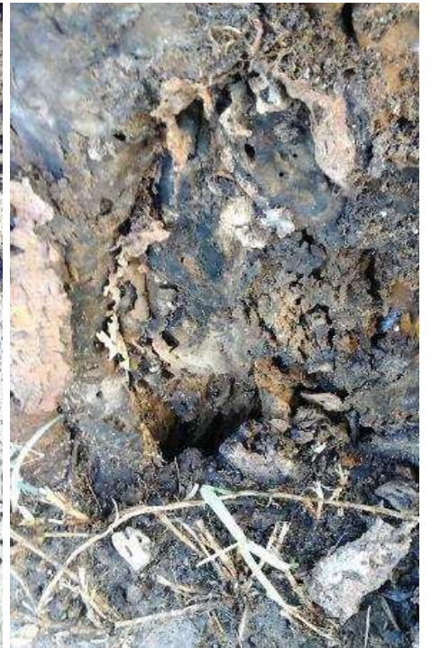
Cavidad en la base del tronco/cuello del árbol que seguramente afecte a la base de las raíces maestras.
